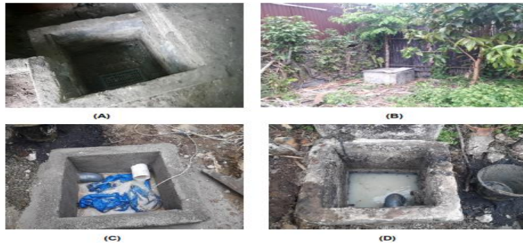
Gambar 4. (A) Bak Penampungan I (B) Bak Penampungan II (C) Bak Penampungan III (D) Bak Penampungan IV (Bak Kontrol)
